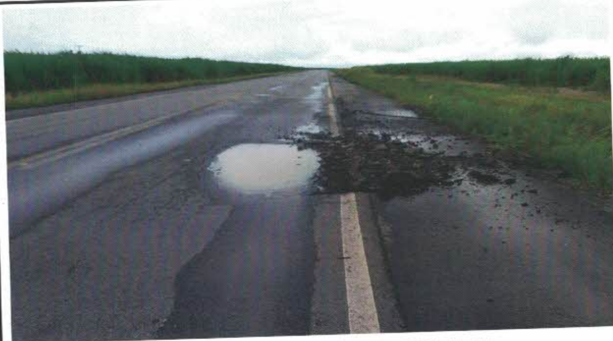
ITEM 07 – LOCALIZAÇÃO: RODOVIA AL 105 LAT: -9,85012120 LONG: -36,3415062 PRECISÃO: 10M
