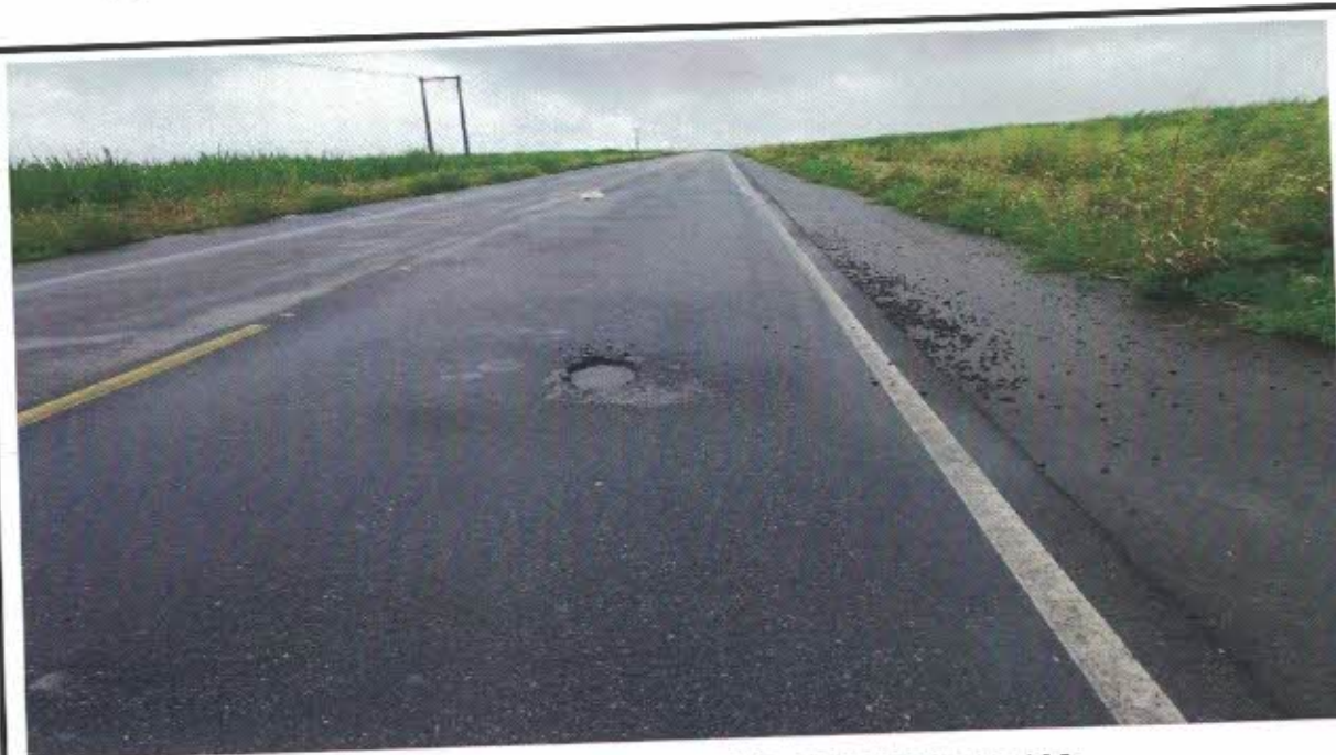
ITEM 03 – LOCALIZAÇÃO: RODOVIA AL 105 LAT: -9,8405890 LONG: -36,3483900 PRECISÃO: 10M
