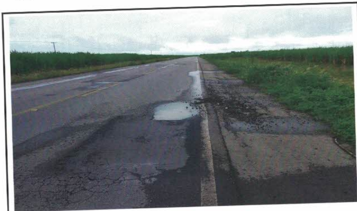
ITEM 09 – LOCALIZAÇÃO: RODOVIA AL 105 LAT: -9,8527160 LONG: -36,3379840 PRECISÃO: 10M
