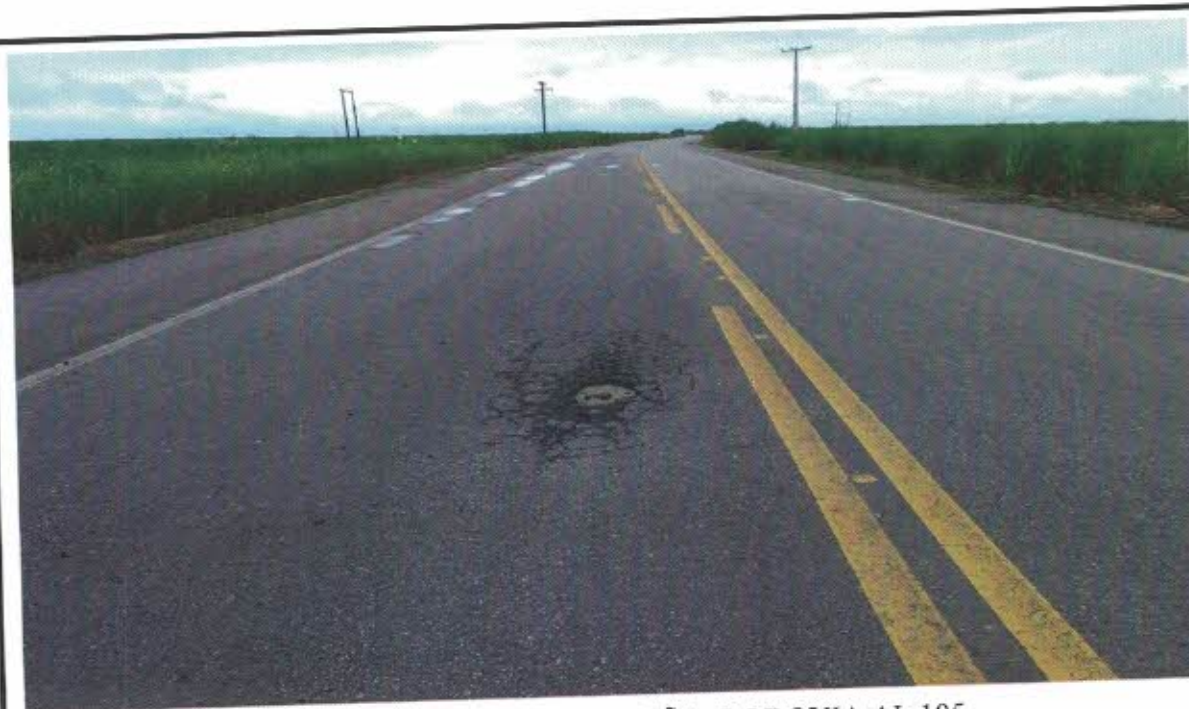
ITEM 08 – LOCALIZAÇÃO: RODOVIA AL 105 LAT: -9,8731970 LONG: -36,3267940 PRECISÃO: 10M
