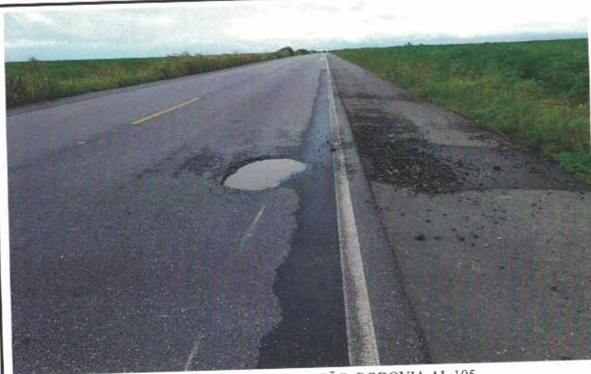
ITEM 12 – LOCALIZAÇÃO: RODOVIA AL 105 LAT: -9,8849670 LONG: -36,3157810 PRECISÃO: 10M
