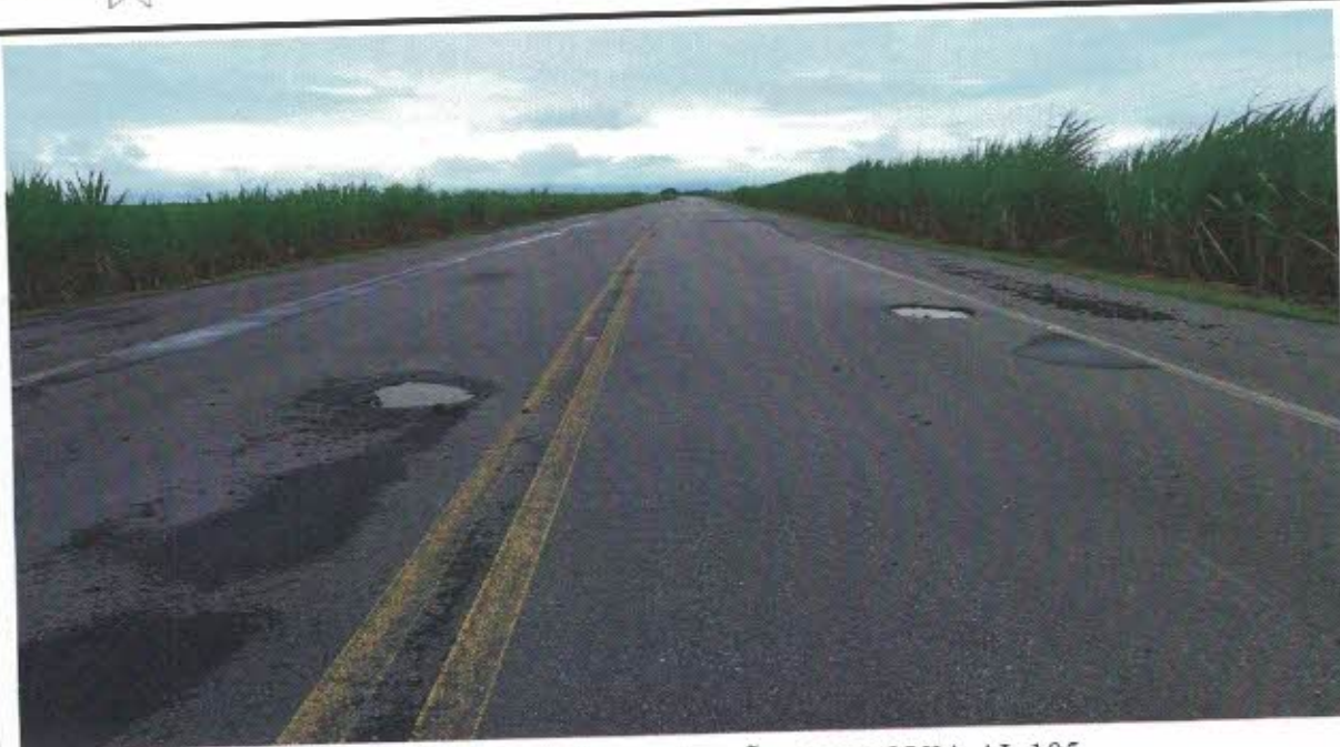
ITEM 11 – LOCALIZAÇÃO: RODOVIA AL 105 LAT: -9,8738010 LONG: -36,3265600 PRECISÃO: 10M
