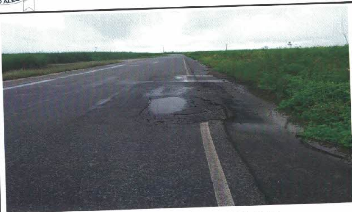
ITEM 05 – LOCALIZAÇÃO: RODOVIA AL 105 LAT: -9,8451030 LONG: -36,3447280 PRECISÃO: 10M
