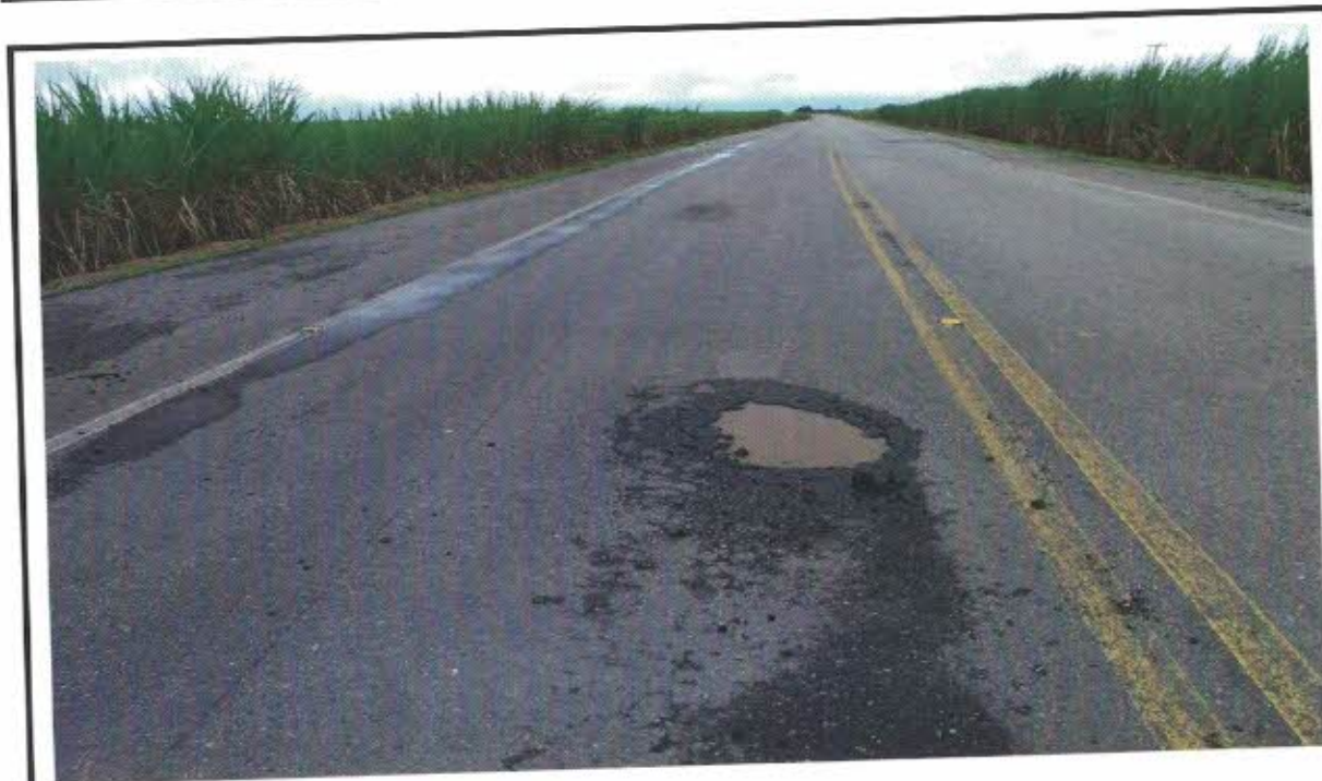
ITEM 10 – LOCALIZAÇÃO: RODOVIA AL 105 LAT: -9,8735980 LONG: -36,3266330 PRECISÃO: 10M
