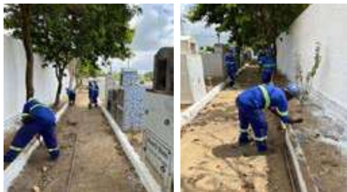
D) INSTALAÇÕES DE TORNEIRAS NO CEMITÉRIO
